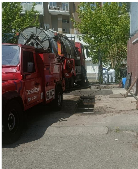
Limpeza e desentupimento das fossas de recolha das lavagens de viaturas
