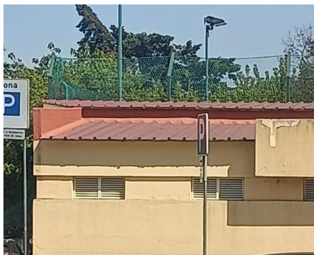
Área a reparar e pormenor da reparação
